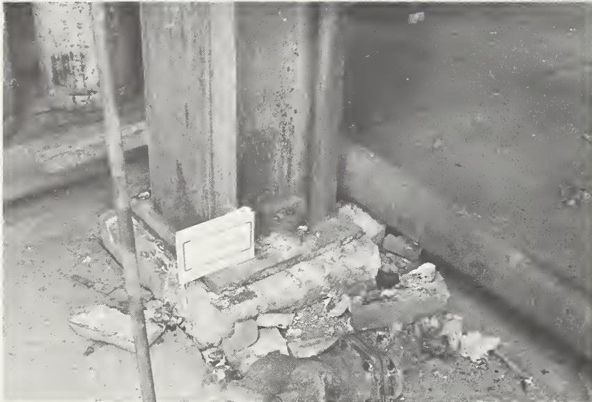
Figure 22-2 Broken anchor bolts in boiler columns, Planta Eléctrica ENALUF.
