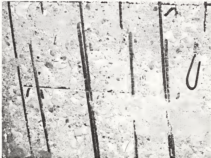
Parte inferior de la losa sin cubierta de hormigón. Refuerzo de acero expuesto
