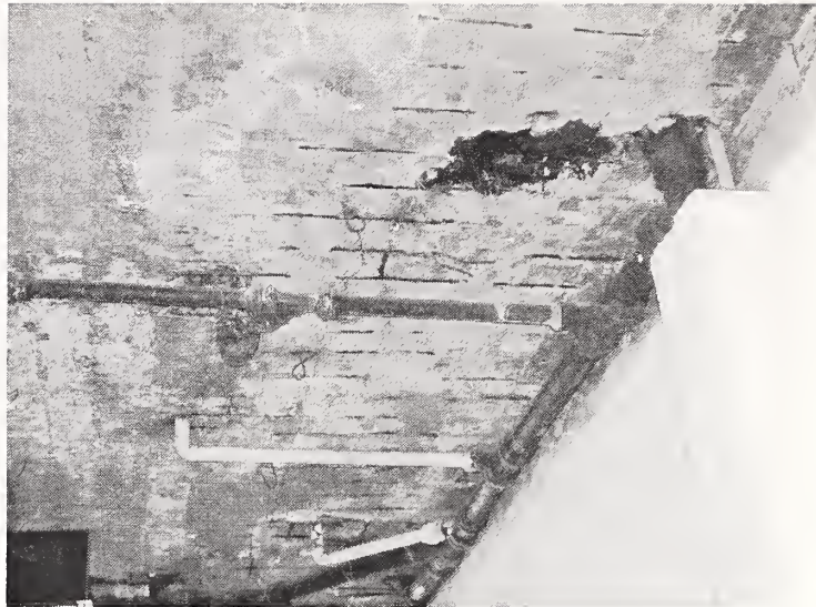
Losa del segundo piso extensamente deteriorada
